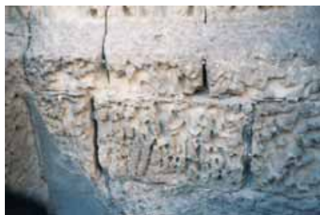
figura x - Ejemplo de sillar antes de su restauración. Los sillares bajos de las rocas más porosas (las calizas oolíticas y las calcarenitas), han sufrido importantes procesos erosivos de arenización y alveolización . Estos procesos están relacionados con la humedad del suelo, que asciende por capilaridad a través de los sillares arrastrando iones salinos. A partir de dichas soluciones y su interacción con la roca se forman minerales cuya presión de cristalización "rompe" la roca.
