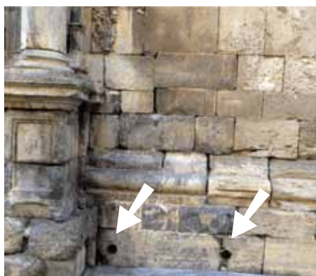
figura x - Para evitar este deterioro del edificio, los bloques más afectados fueron sustituidos y se montaron respiraderos (indicados con flechas) para interferir en el proceso del ascenso capilar de la humedad.
